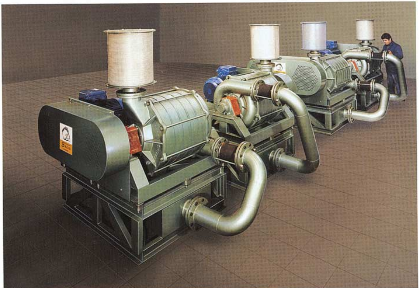
Sala di pompaggio aria - Salle de pompage d'air - Air pumping room - Sala de bombeo aire
